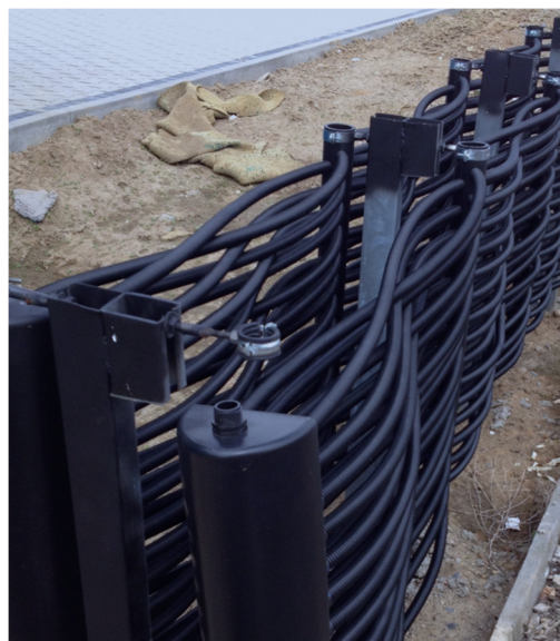
Рис. 6 Надземна частина енергетичного паркану
